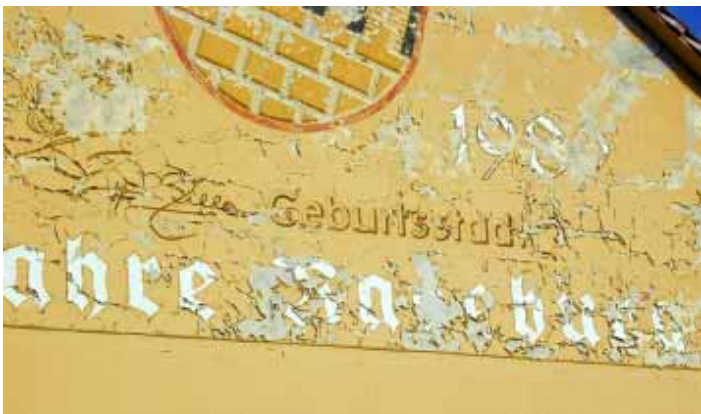
Beschämend: Fassade mit Resten eines Zille Motives
