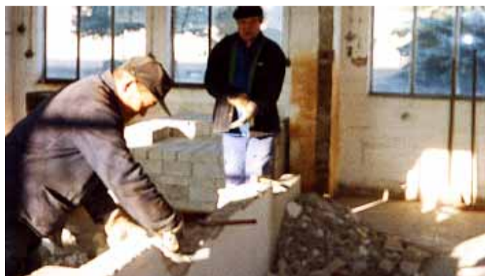
Vorbereitungsarbeiten zur Schaffung von Baufreiheit für die geplante Baumaßnahme des Feuerwehrgerätehauses Schönfeld laufen gut an.
