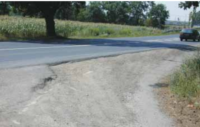
Der Radweg ist von der abgefahrenen Böschung nahezu restlos verschüttet.
