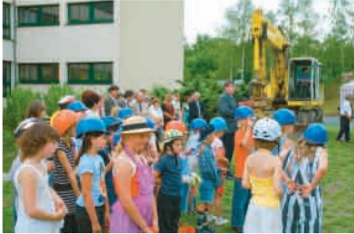
Gespannt warten die Schüler während der Rede von Herrn Jesse auf den ersten Spatenstich.
