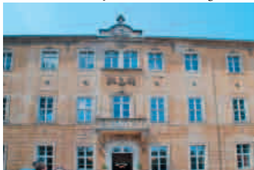
Die notleidende Fassade des Schlosses kann nun endlich saniert werden.
