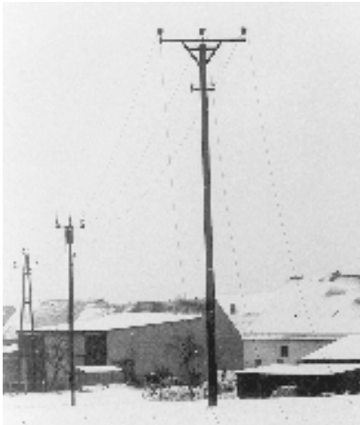
Diese alte Hochspannungsleitung am Weinbergsweg für die Versorgung der Ortslage Schönfeld mit Energie ist bereits am 10.1.97, nach über 70-jährigem Bestehen, gefallen. Die neue 20 KV Leitung wurde im Süden und außerhalb der Ortslage errichtet und bereits in Betrieb genommen.
